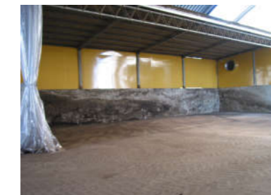
原料は混合され、一次発酵槽で調整・発酵が行われます。
